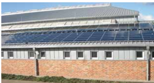
Abbildung 15: Photovoltaikanlage auf Sporthallendach in Molbergen, Quelle: VR Bürger-Energiepark eG
